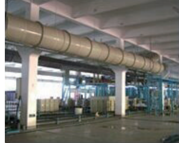
电镀废气处理排气工程
